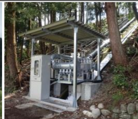
小水力発電設備の外観
