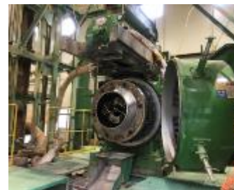
ペレット製造装置
