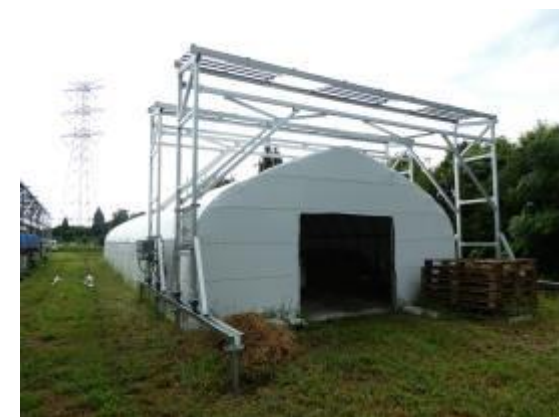
移動可能な太陽光架台
