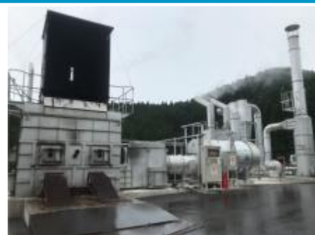
バークボイラー
