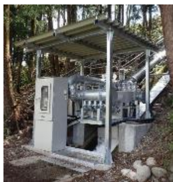
有効落差11mを利用した マイクロ水力発電
