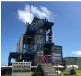
海洋温度差発電実証プラント外観
