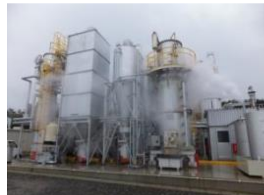
バイオマス設備
