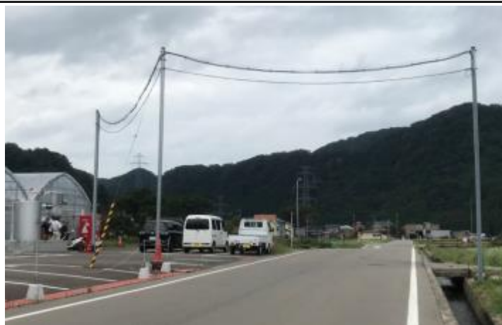
発電所からハウスへの送電線 ©2023 JMA Consultants Inc.
