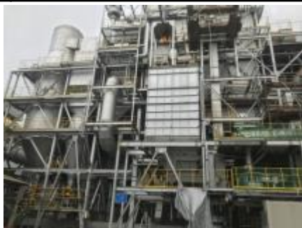
バイオマス発電設備
